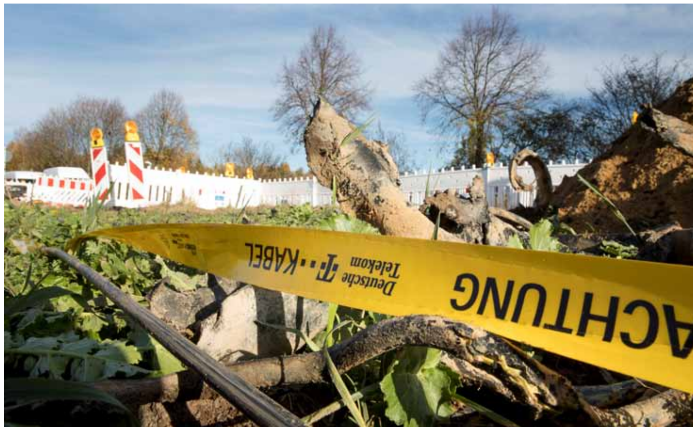
Dieses Glasfaserkabel der Telekom wurde bei Bohrarbeiten in 2,50 Metern Tiefe beschädigt. Es versorgt Ochtmissen mit Internet. Foto: t&w
